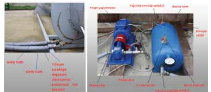
Şekil 9. Kollektörler arası bağlantı (sol), kızgın yağ pompası ve basınç tankı (sağ)
